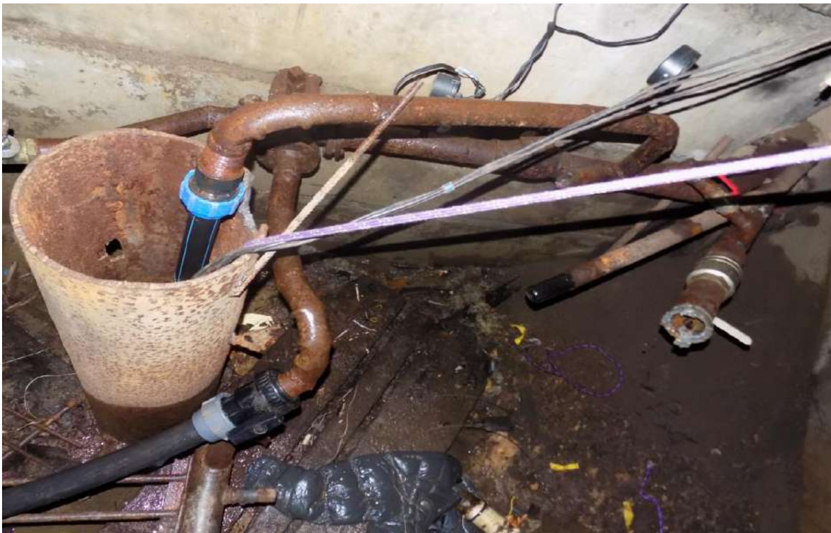
Сооружение – скважина буровая п. Верхние Малюки, кадастровый номер 74:19:1601002:101
